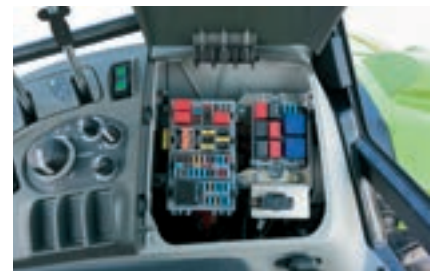
Les fusibles du circuit électrique sont installés de façon centrale dans la cabine.
